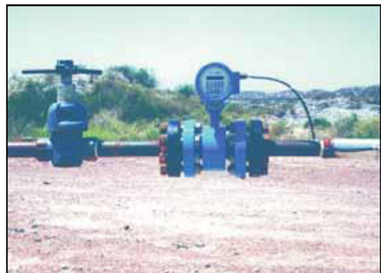
Equipo instalado en un yacimiento
